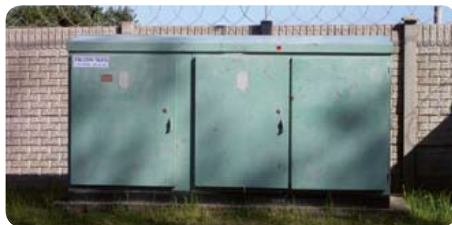
Cuadro eléctrico, tipo 410 pintado, Sudáfrica.
